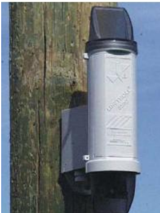
Figura 08: IF instalado no poste. Fonte: SOUZA(2009)
