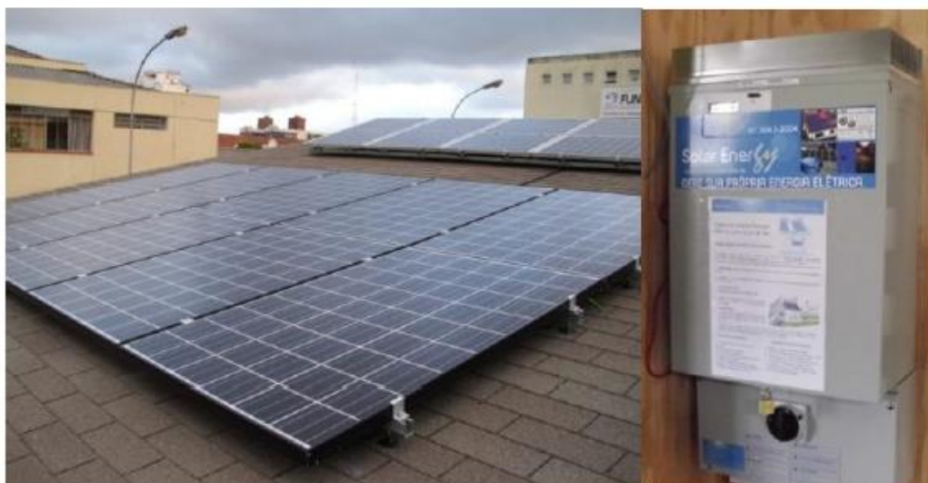
Figura 4.1 - Painel FV e inversor do EV da UTFPR Fonte: URBANETZ et al., 2013
