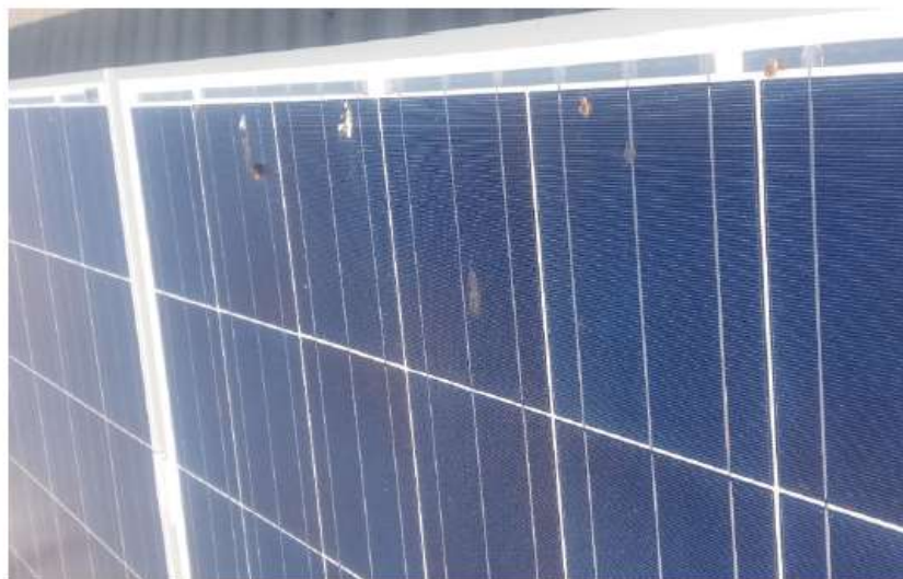
Figura 19 - Sujeira no Módulo Fotovoltaico do Neville.
