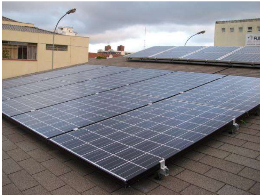
Figura 16 - Painel Fotovoltaico do Escritório Verde.
