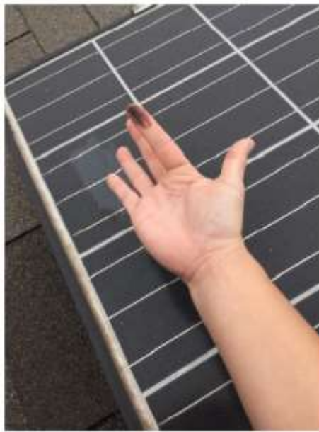
Figura 18 - Detalhe da sujeira nos módulos do Escritório Verde antes da limpeza.
