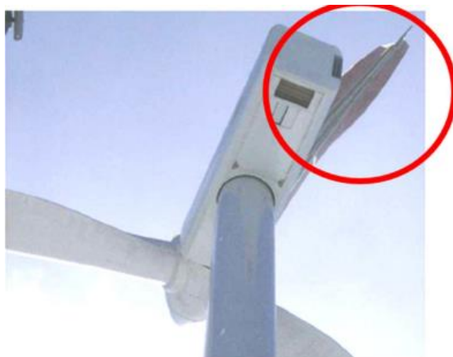
Figura 18 - Exemplo de dano por descolamento em aerogeradores Fontes: WETZEL, 2009
