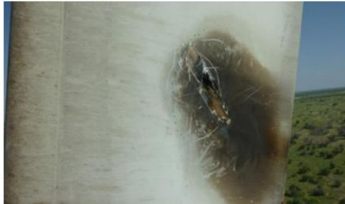
Figura 17 - Exemplo de dano por delaminação em aerogeradores Fonte: N. WILSON, 2013
