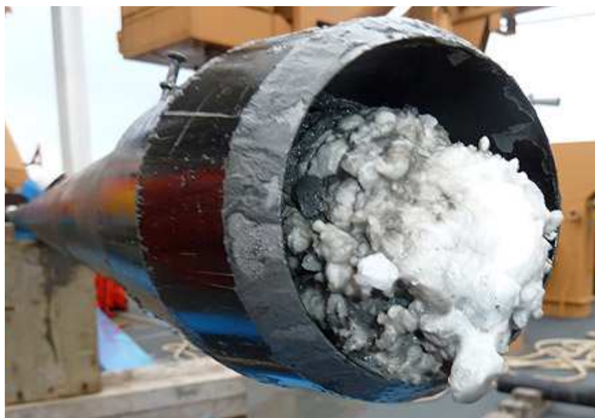
Figura 2.1 – Imagem de uma tubulação obstruída por hidratos
