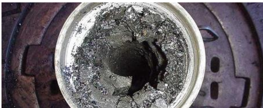
Figura 1.1. Oleoduto com da seção útil de escoamento reduzida devido à deposição.
