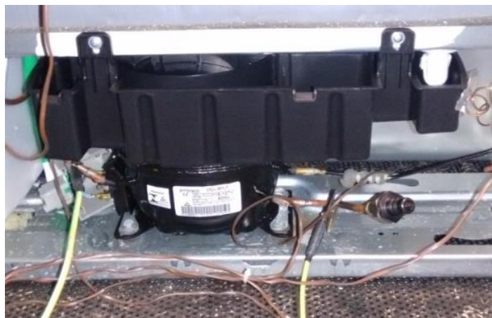
Figura 4 - Calha de degelo montada no topo do compressor. Fonte: O Autor. Local: Electrolux do Brasil.
