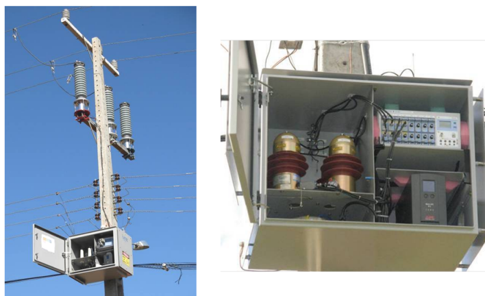
Figura 59: Detalhe do sistema de monitoramento.
