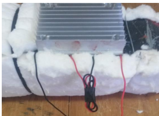
Figura 19 – Ligação elétrica dos Módulos FONTE: Autoria própria
