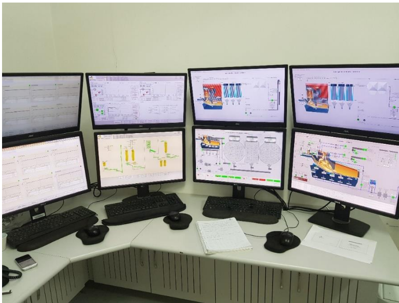
Fotografia 3 -Sistemas supervisórios de 4 caldeiras e seus sistemas de alimentação, refrigeração e de processos.
