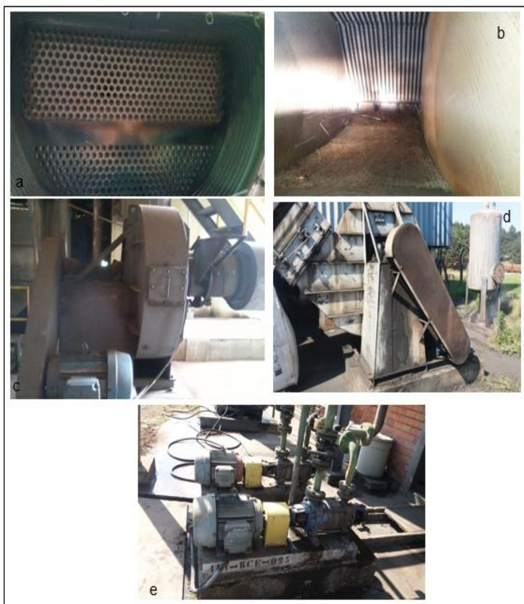
Figura 07 – (a) Balão da Caldeira de Biomassa, (b) Fornalha da Caldeira de Biomassa, (c) Ventilação da caldeira de biomassa, (d) Exaustão da Caldeira de Biomassa e (e) Abastecimento de água da Caldeira de Biomassa
