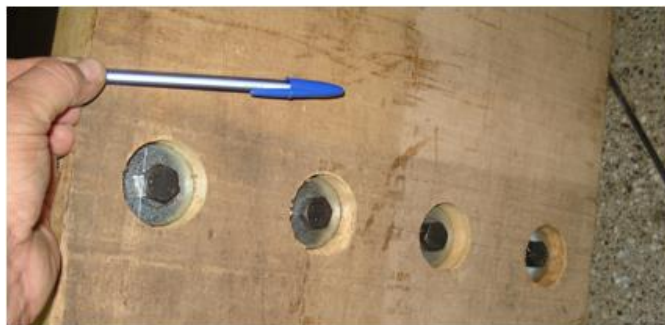
Figura 24 – Vista dos parafusos idas arruelas. Fonte – Arquivo do autor.
