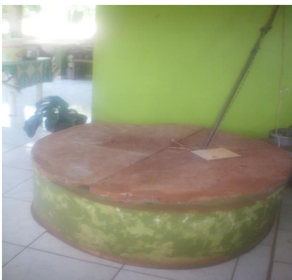
Figura 4 - Poço 1 - área rural
