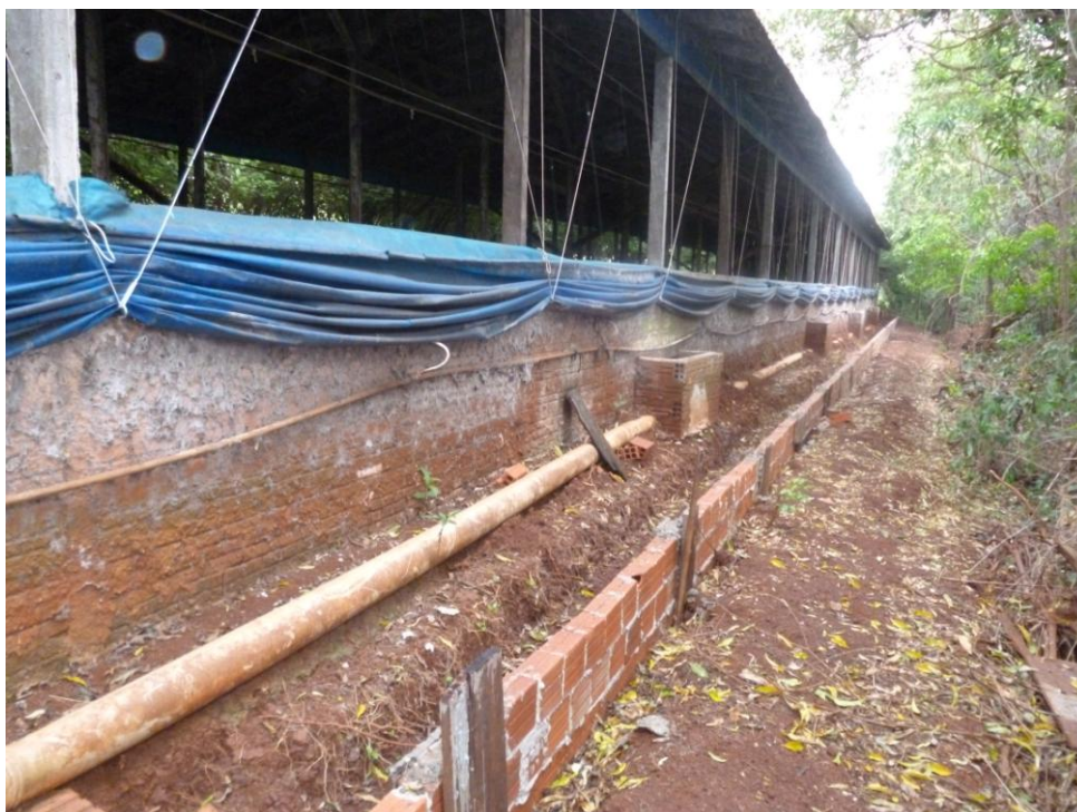
Figura 12 - Tubulações a mostra e caixas de manejo destampadas
