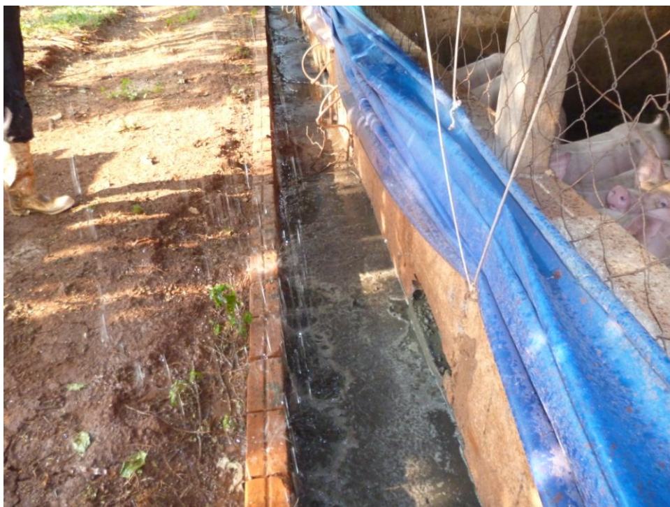
Figura 6 - Entrada de água da chuva na canaleta de manejo dos dejetos
