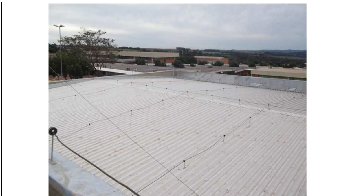
Figura 5 – Para Raios Tipo Faraday no RU da UTFPR câmpus Medianeira Fonte: Autor.
