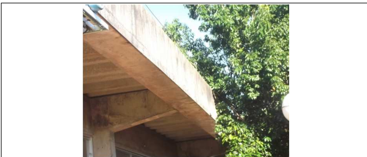
Figura 28 – Bloco I3, árvore em contato com a instalação Fonte: Autor.
