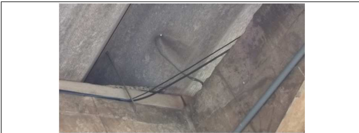
Figura 27 – Subestação 1, condutor de descida embutido na estrutura de concreto Fonte: Autor.
