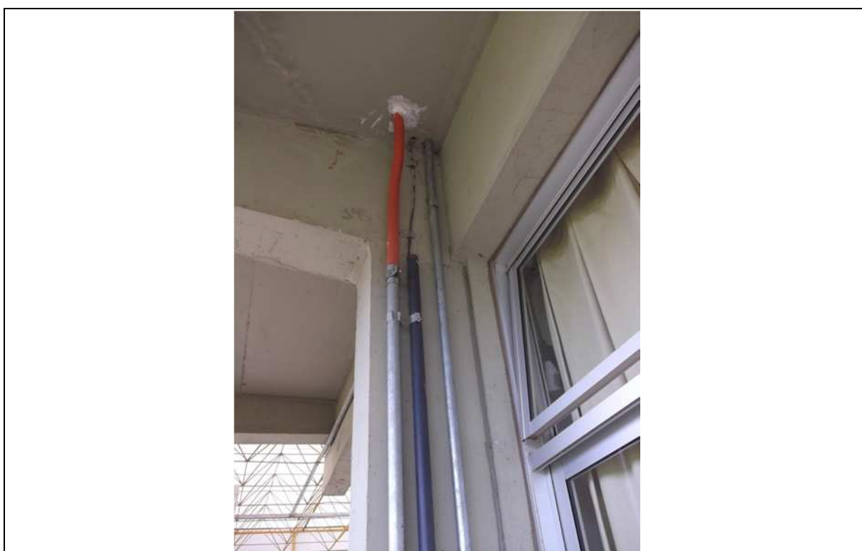
Figura 20 – Bloco L1, instalações metálicas instaladas a menos de dois metros do SPDA Fonte: Autor.
