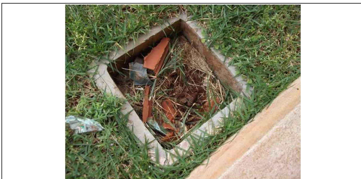
Figura 19 – Bloco L1, conector de medição enterrado Fonte: Autor.
