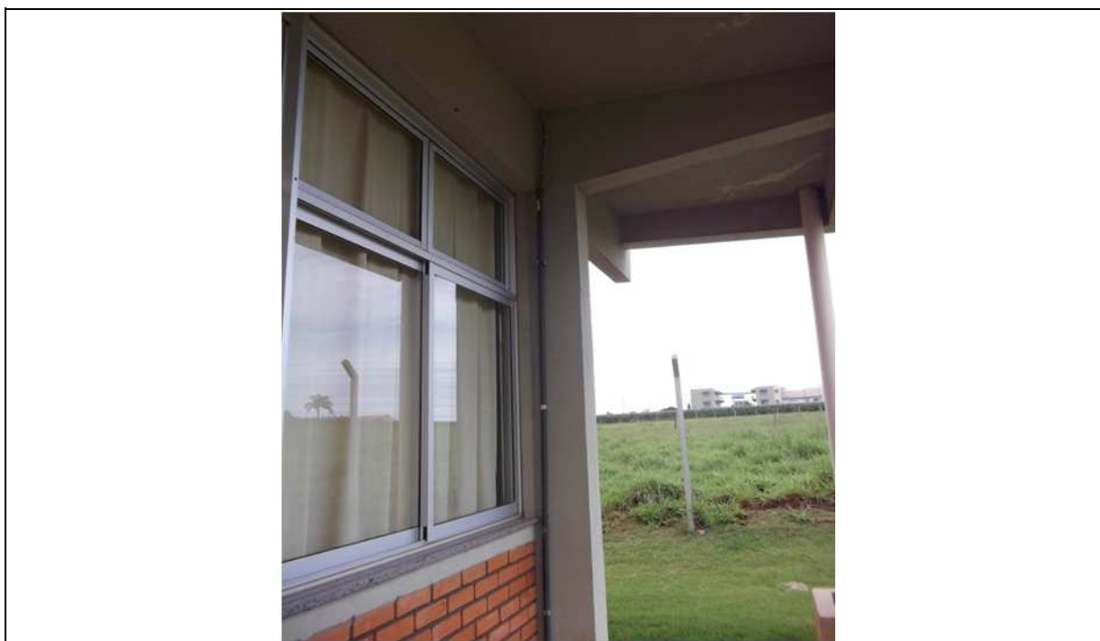
Figura 25 – Bloco L1, subsistema de descida instalado próximo às aberturas Fonte: Autor.
