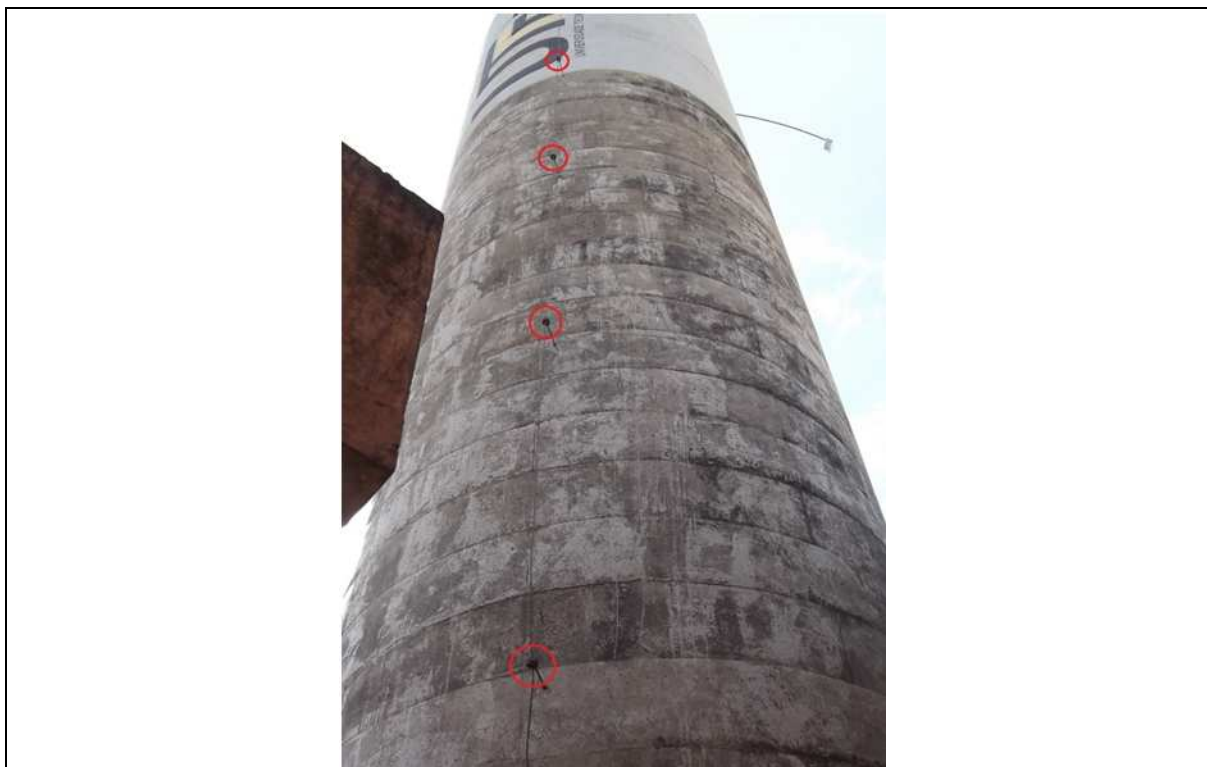
Figura 26 – Caixa d'água, condutores de descidas fixados a mais de um metro de distância Fonte: Autor.
