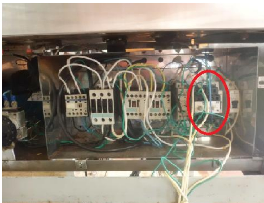
Figura 2 - Antigo Quadro Comando (Detalhe dos temporizadores)
