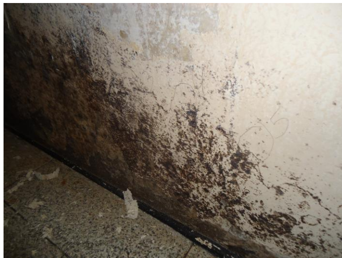
Figura 18 - Região A - fachada sul da lavanderia Fonte: Autoria própria.
