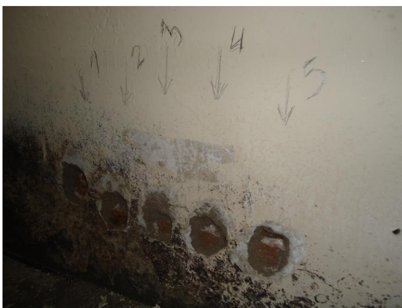
Figura 20 - Coleta de amostras da superfície da fachada sul da lavanderia Fonte: Autoria própria.
