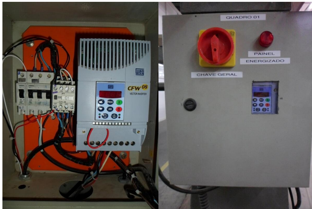
Figura 27: quadro elétrico 01 Fonte: Jeferson E. Lissadalpra
