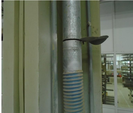
Figura 12:: portinhola de abertura da exaustão Fonte: Gabriel da Silva
