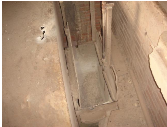
Figura 5 – Damper na entrada do secador
