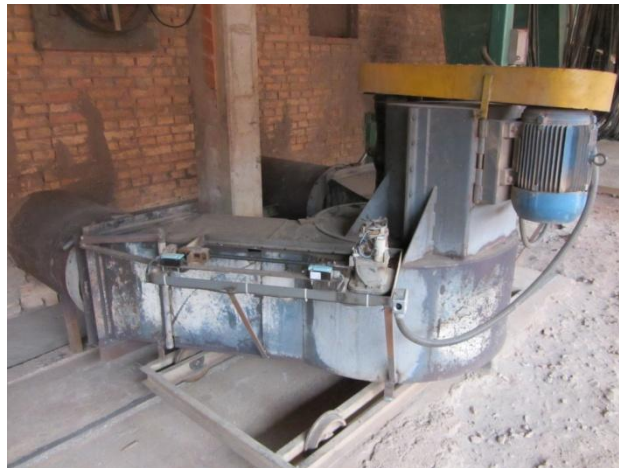
Figura 2 – Exaustor para transferência de calor
