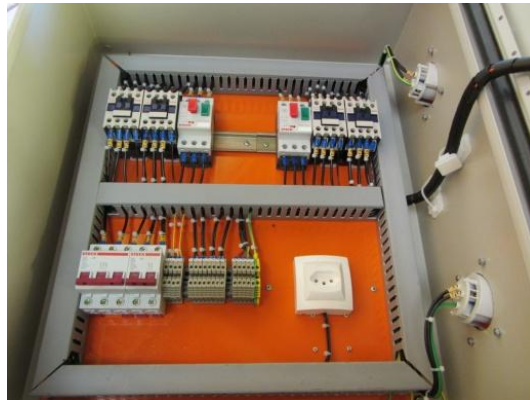
Figura 18 – Quadro de comando
