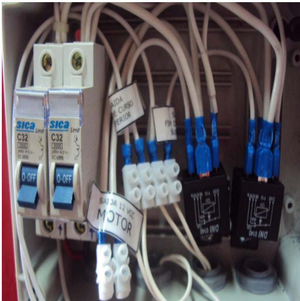
Figura 17 – Elementos elétricos Fonte: Própria
