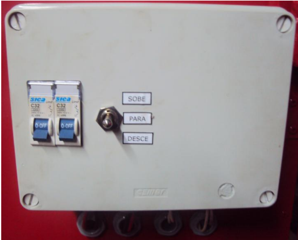
Figura 18 – Painel elétrico Fonte: Própria
