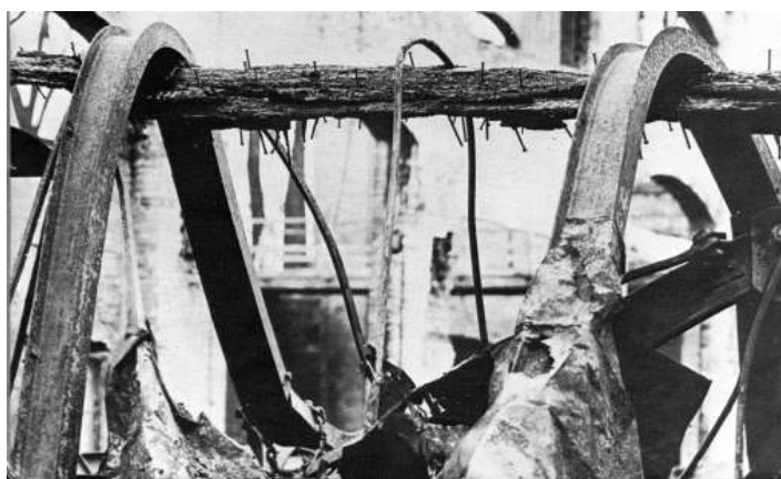
Figura 7 - Fotografia após incêndio Fonte: MADEIRA ESTRUTURAL, 2009.
