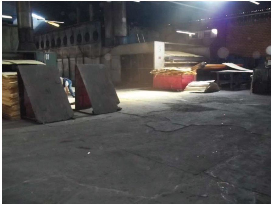
Figura 13 – Estado inicial do piso do barracão existente Fonte: Autores (2013).
