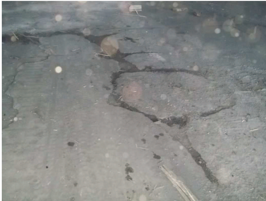
Figura 11 – Defeitos do piso existente Fonte: Autores (2013).
