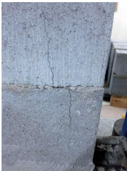
Figura 61 - P3'6, fissuras frontais
