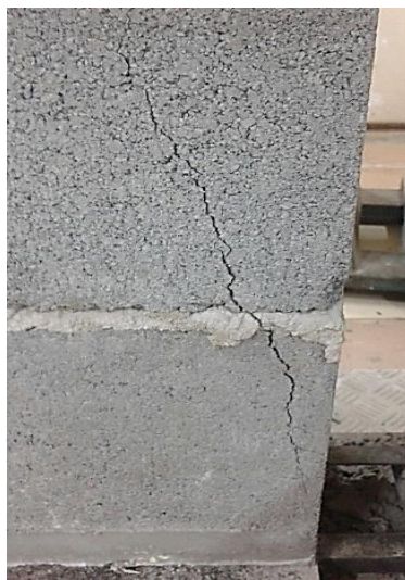
Figura 56 - P2'2, fissuras traseiras Fonte: (AUTORIA PRÓPRIA, 2017).
