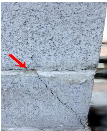
Figura 48 - P1'1, fissuração frontal Fonte: (AUTORIA PRÓPRIA, 2017).
