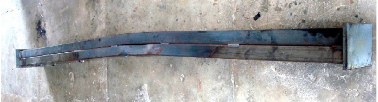
Figura 13 - Deformações no perfil caixão após ser submetido à temperaturas elevadas
