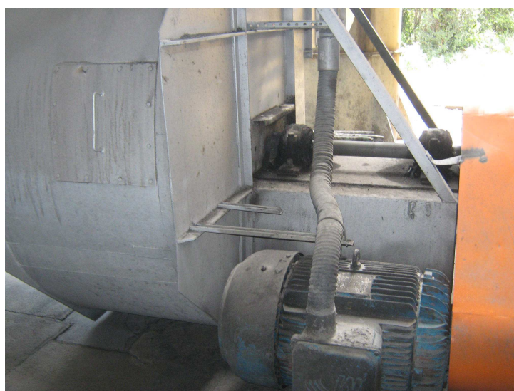
Figura 12: Motor de 125 CV e exaustor da Caldeira.
