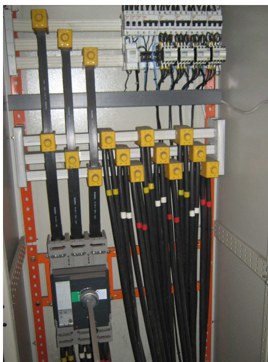
Figura 10: Disjuntor geral de 800 A.
