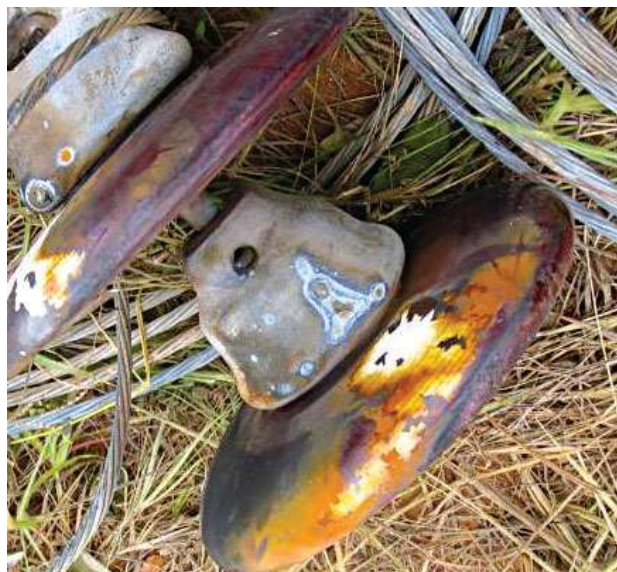
Figura 17 – Isolador com isolamento rompido.
