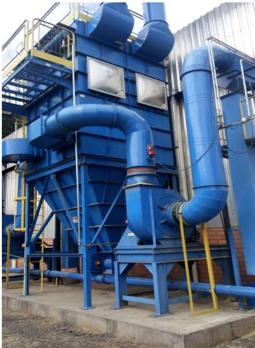
Fotografia 1 – Exaustor do Setor Finger Joint
