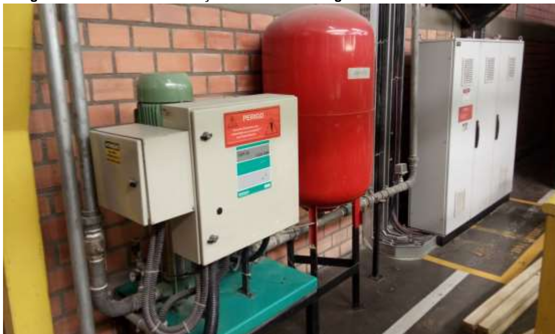
Fotografia 5 – Unidade de Elevação de Pressão de Água
