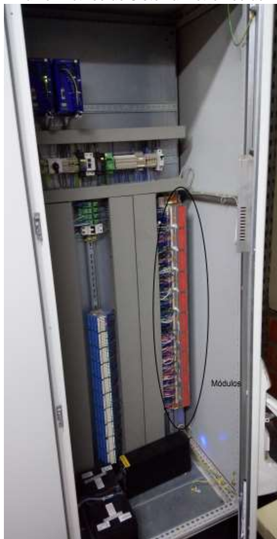
Fotografia 4 – Painel Elétrico do Sistema Eletrônico de Extinção de Faíscas
