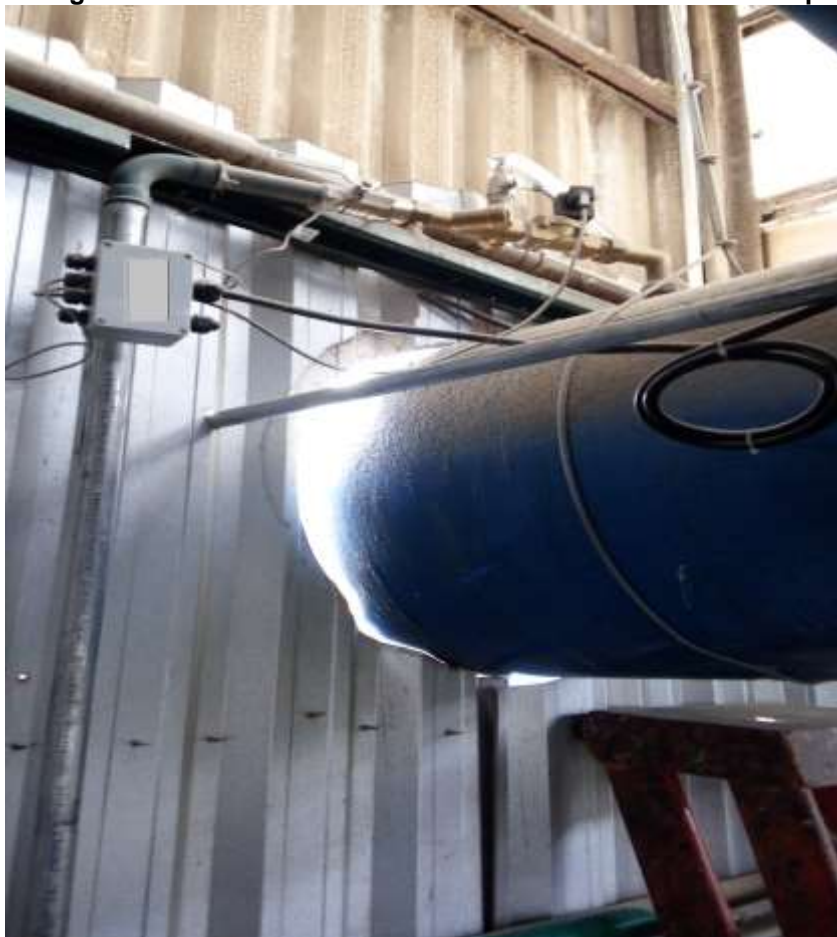
Fotografia 6 – Extintor Instalado em um dos Exaustores da Empresa
