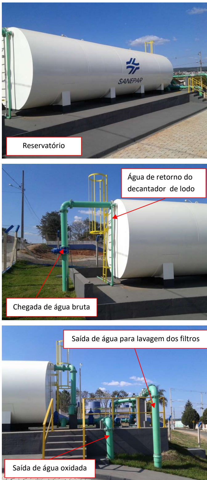
Figura 06 – Reservatório apoiado de contato
