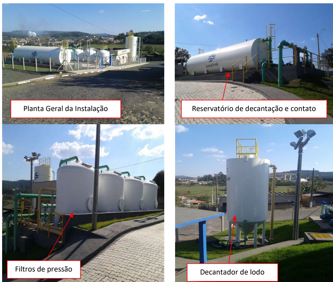
Figura 02 – Planta de tratamento por oxidação química e filtros de pressão
