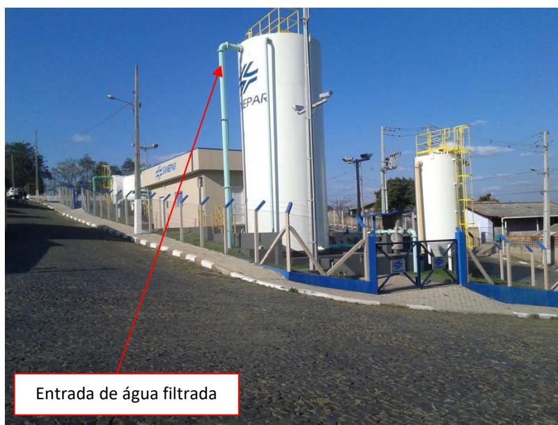
Figura 08 – Reservatório de distribuição
