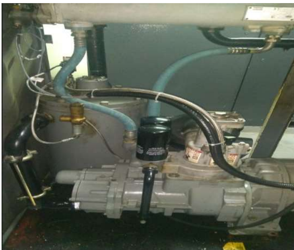
Figura 21 – Compressor GA 75 W Atlas Copco. Fonte: Autoria própria.
