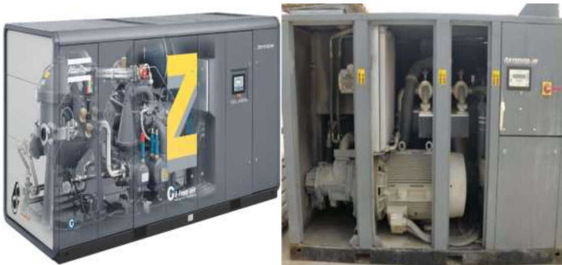
Figura 1 – Compressor industrial. Fonte: Autoria Própria.
