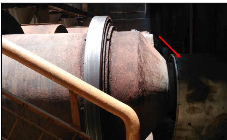
Figura 14 – Regulagem da entrada de ar secundário quebrada substituída por isolamento.
