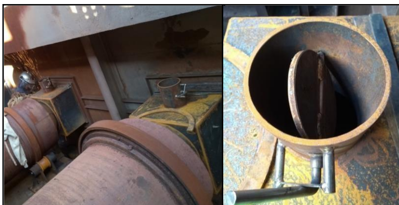
Figura 21 – Modificação na entrada de ar secundário dos fornos rotativos.
