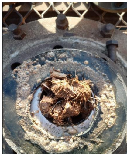
Figura 20 – Bico ejetor obstruído.
