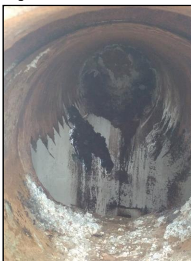
Figura 18 – Vista interna da tubulação corroída.
