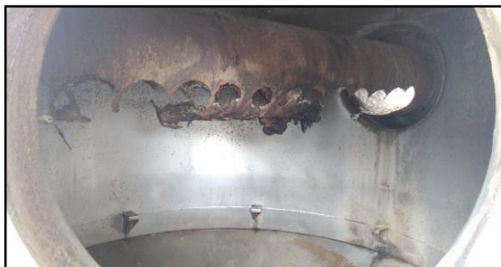
Figura 19 – Vista lateral da tubulação corroída.
