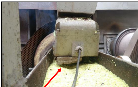
Figura 12 – Calço sob motor da calha vibratória.
