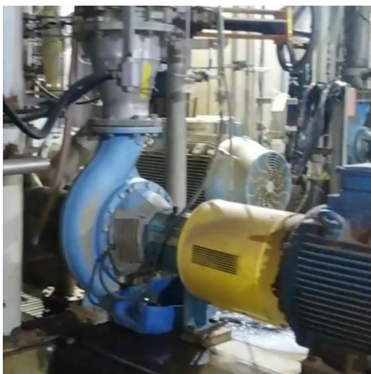
Figura 11 – Bomba com vedação de gaxeta
