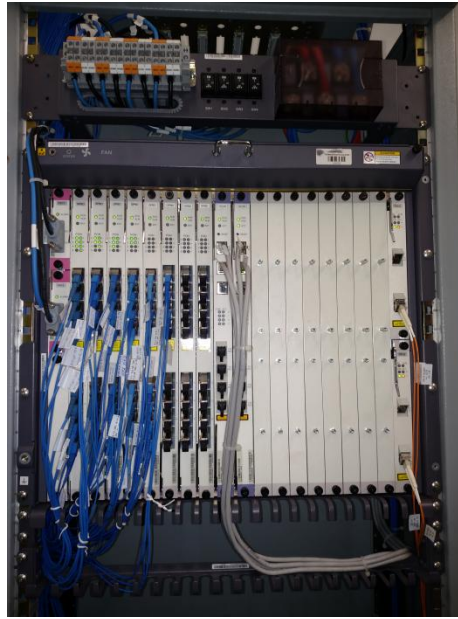
Figura 23. OLT Huawei instalado em um POP de operadora. Fonte: Autoria Própria
