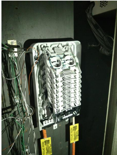
Figura 17. Distribuidor Geral Óptico. Fonte: Aatoria Própria
