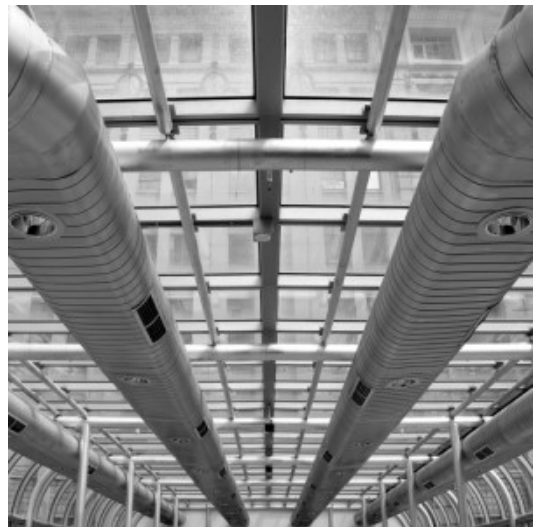
Figura 22 – Distribuição de ar condicionado VRV Fonte: www.arcondicionadosplit.org
