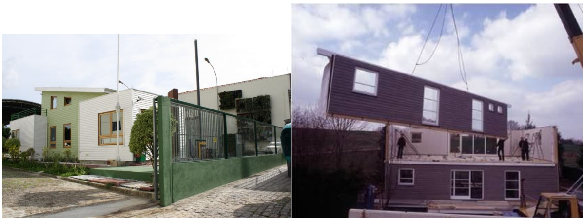
Figura 6 – Exemplo de construções em WLF: A – Escritório Verde da UTFPR e B – Montagem da Ecohaus, ambas em Curitiba-Paraná
