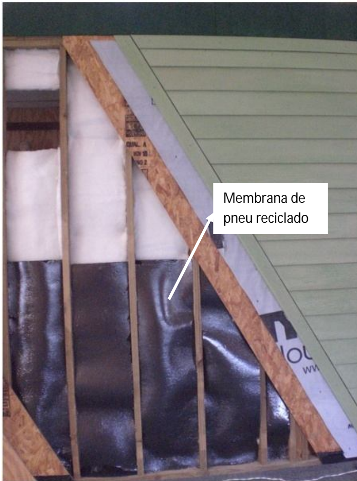
Figura 16 – Estrutura de painel no Escritório Verde com detalhe para a membrana de Pneu reciclado
