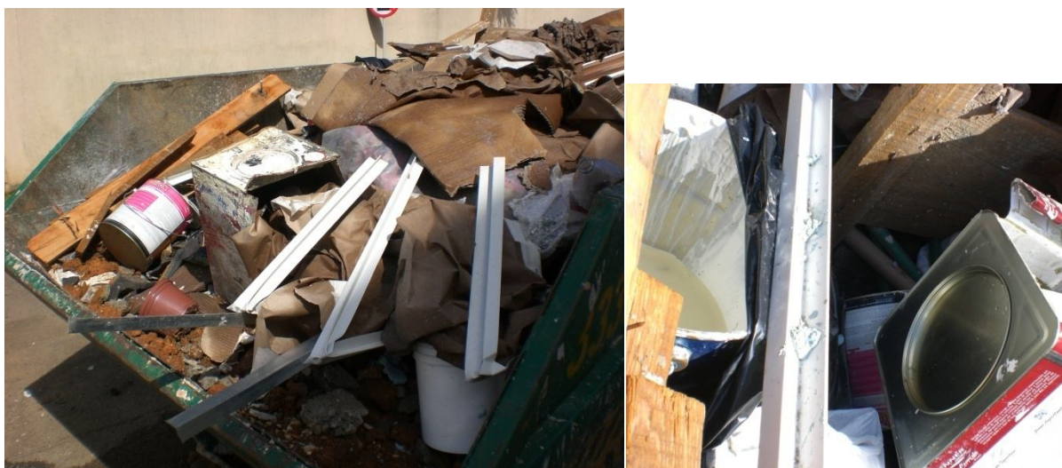
Figura 21 – Caçamba em local da construção sem segregação de resíduos: nota-se que a maioria são restos de acabamentos, mas a empresa responsável pela realização da construção pelo sistema WLF pode intervir no que se trata dos componentes de sua tecnologia construtiva
