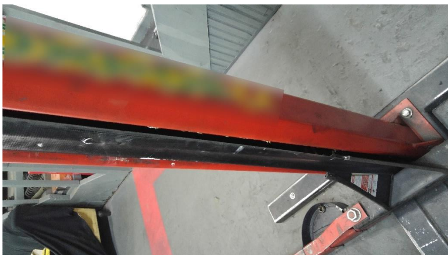
Figura 9: Proteção do vão do elevador.
