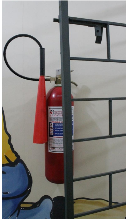
Figura 11 - Extintor obstruído por porta Fonte: Autoria própria (2015)
