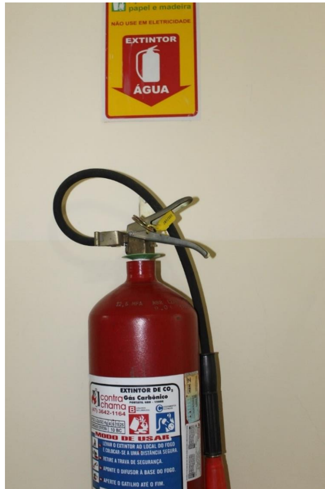
Figura 12 - Sinalização de extintor Fonte: Autoria própria (2015)
