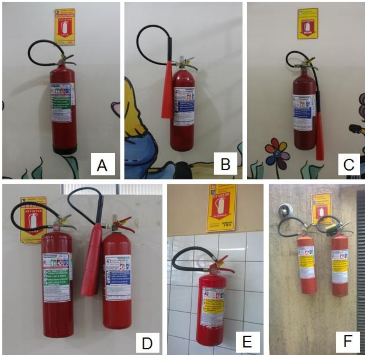
Figura 10 - Sinalização dos extintores Fonte: Autoria própria (2015)
