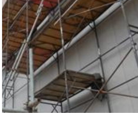
Figura 19: Estrutura sem guarda corpo e sem escadas.
