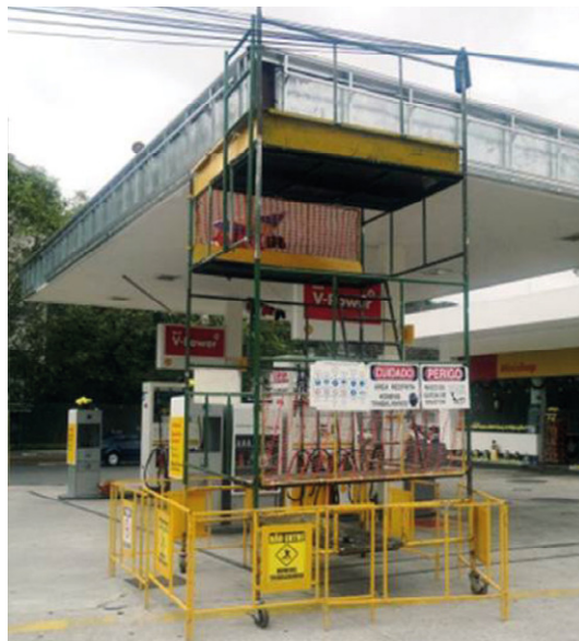
Figura 1: Sinalização e isolamento conforme NR-35. Fonte: BRASIL (2013).
