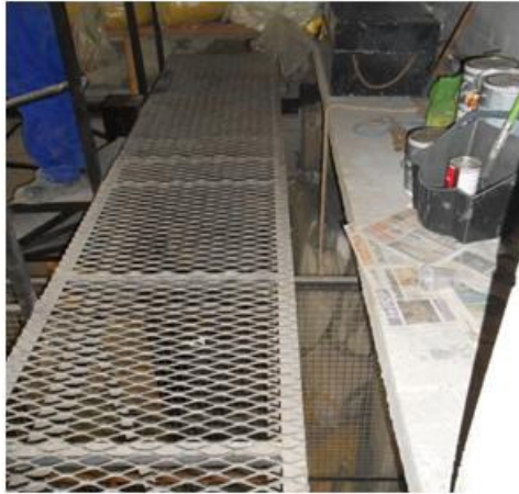
Figura 25: Abertura na área de circulação.
