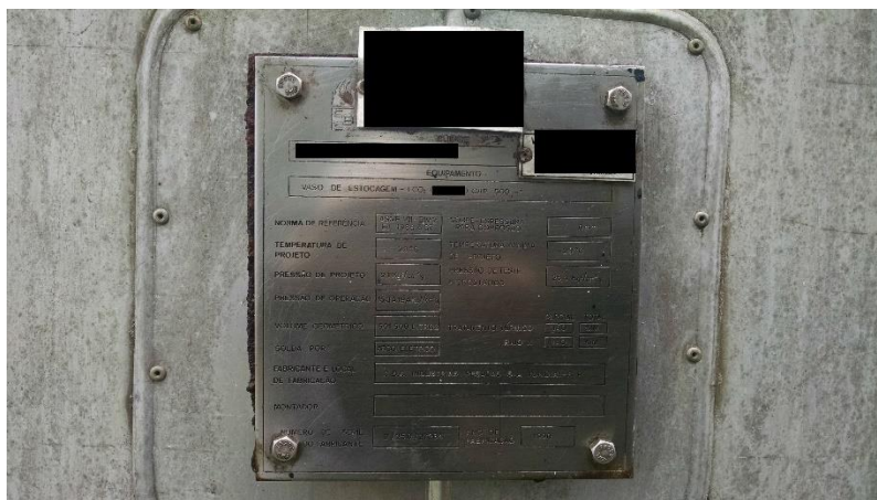
Figura 11 - Placa de Identificação – Tanques A, B e C Fonte: O Autor.
