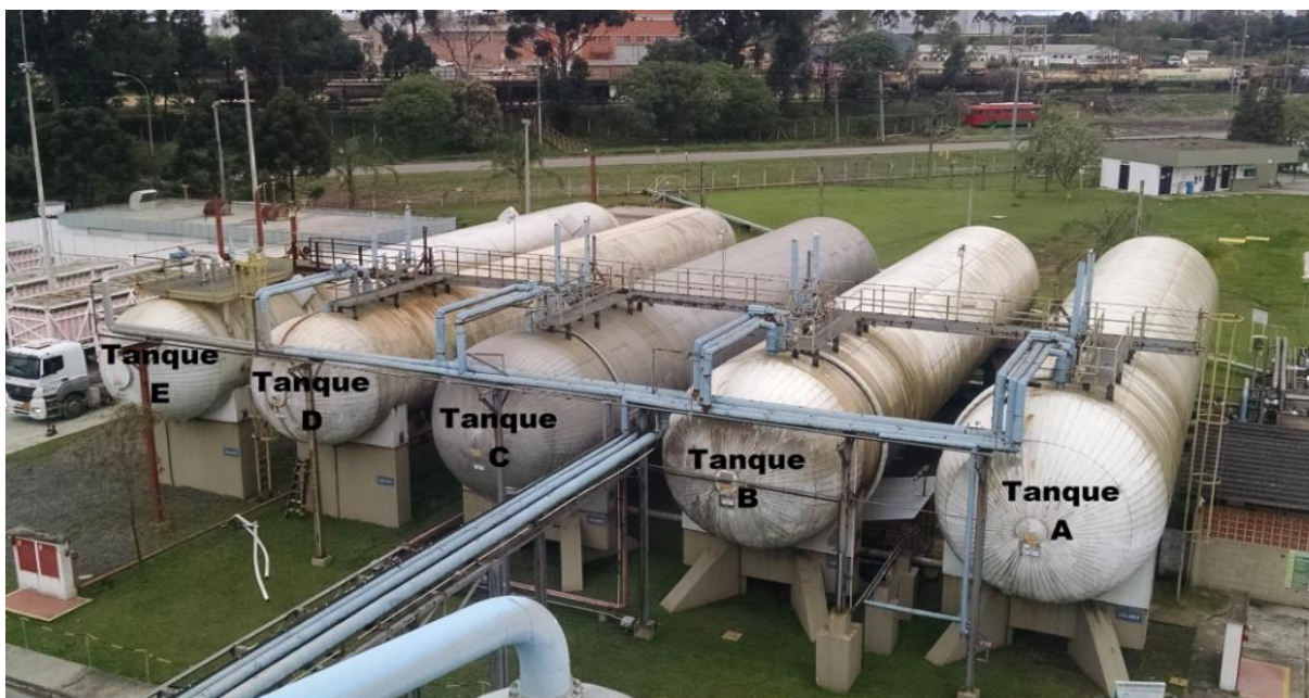
Figura 10 - Vista dos 5 Tanques de CO 2 Fonte: O Autor.
