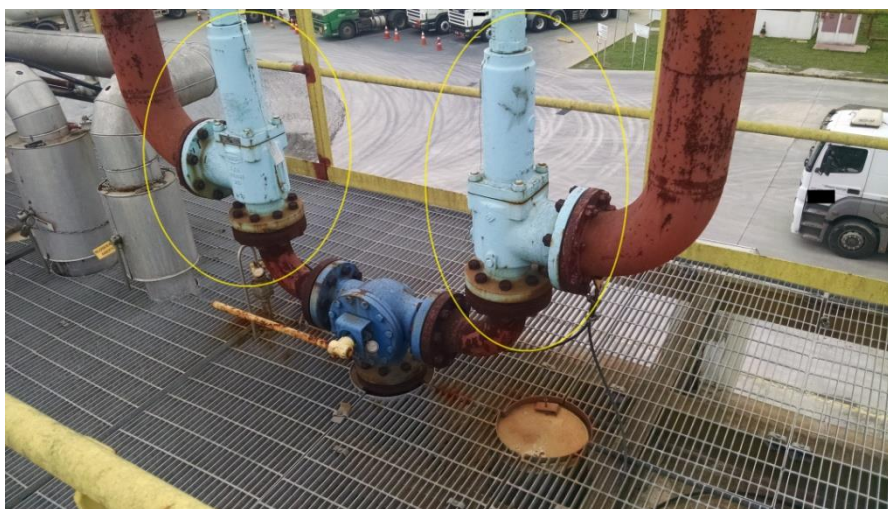
Figura 4 – Dispositivo de Alívio de pressão Fonte: O Autor.
