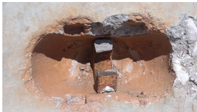
Figura 41 – Lift oxidado e o primeiro a romper no içamento.
