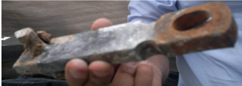
Figura 7 - Inserts metálicos (lift) para fixação da estrutura metálica retirado do acidente
