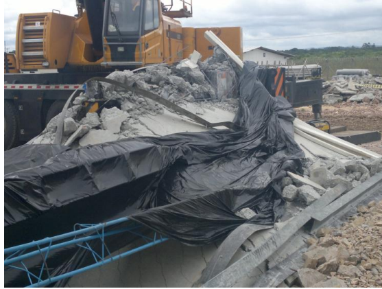
Figura 40 – Queda da Parede Tilt-up sobre o Guindaste, perto da cabine do operador.
