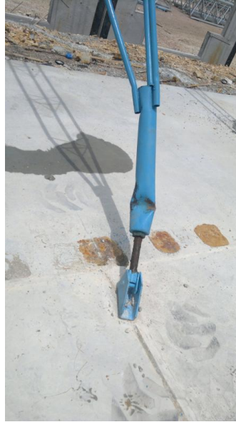
Figura 34 - Acidente com Escora utilizada do Sistema Construtivo Tilt-up Fonte: O AUTOR, 2012
