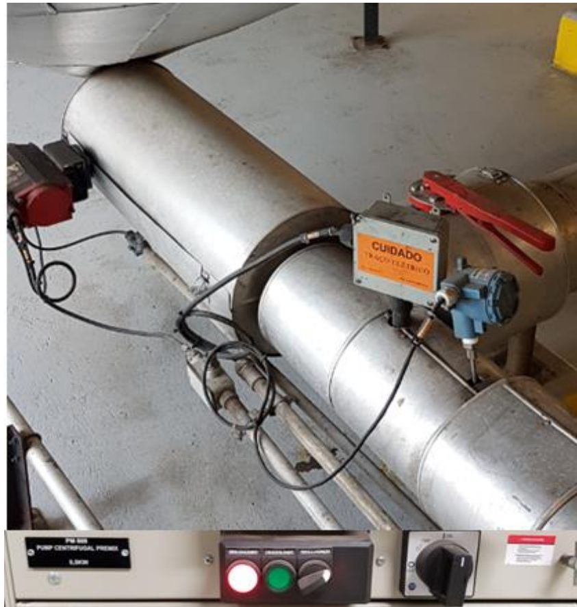
Figura 4: Pontos de bloqueio das fontes de energia do conjunto moto-bomba.
