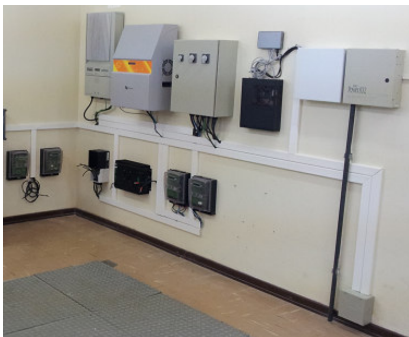
Figura 8 – Detalhe da instalação dos Inversores Fonte: Projeto Piloto COPEL – Sistema Fotovoltaico
