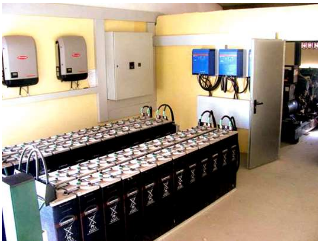
Figura 06: Banco de baterias para um SFVI.
