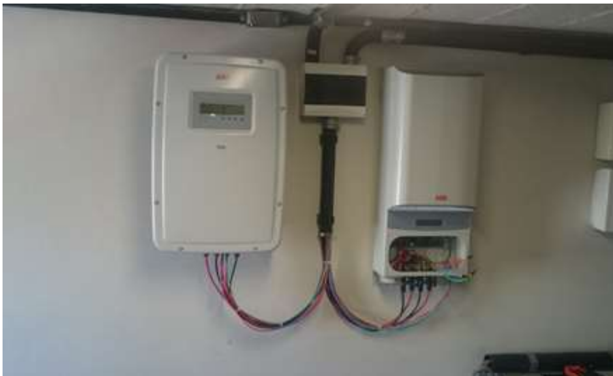
Figura 12: Inversores de frequência.
