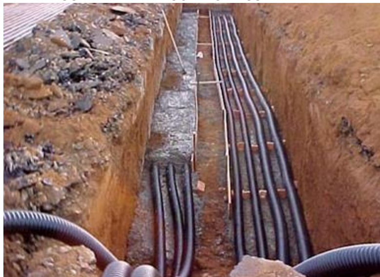
FIGURA 11 – REDE COLETORA SUBTERRÂNEA
