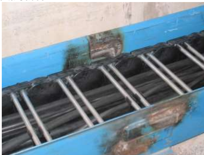
Figura 4.3 - Esteira Porta Cabos
