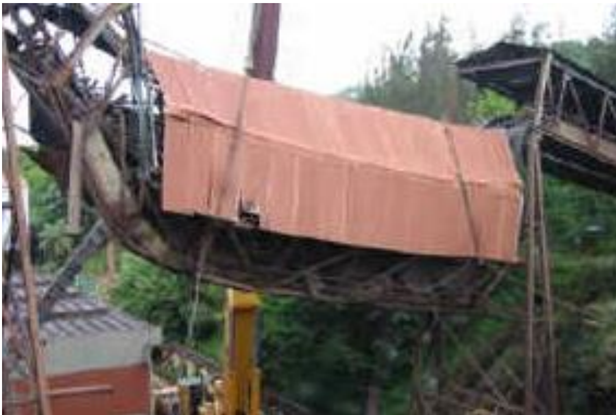
Figura 8 – Colapso em estrutura de Transportador de Correia
