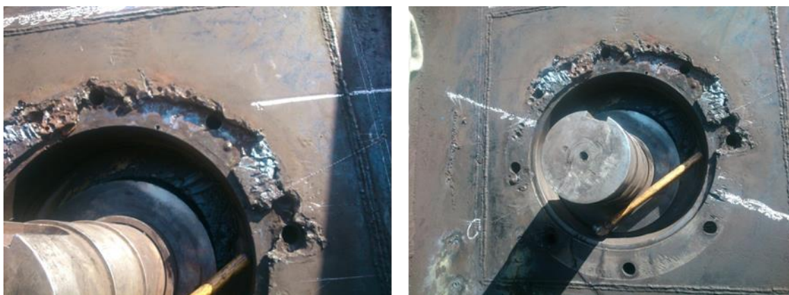
Figura 9 – Estrutura colapsada de uma Peneira Vibratória
