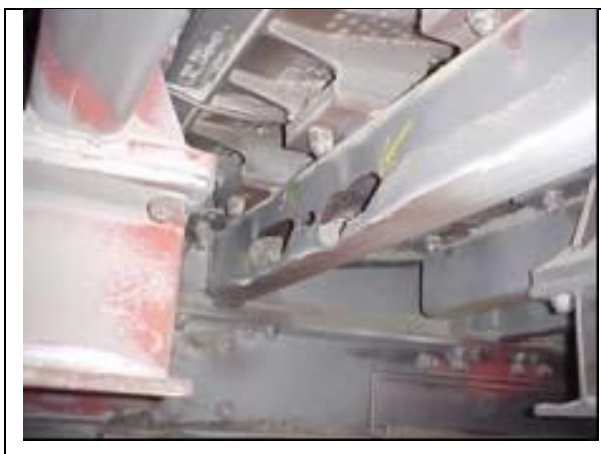
Figura 28 – Viga transversal fixa deformada Fonte: Autoria própria.
