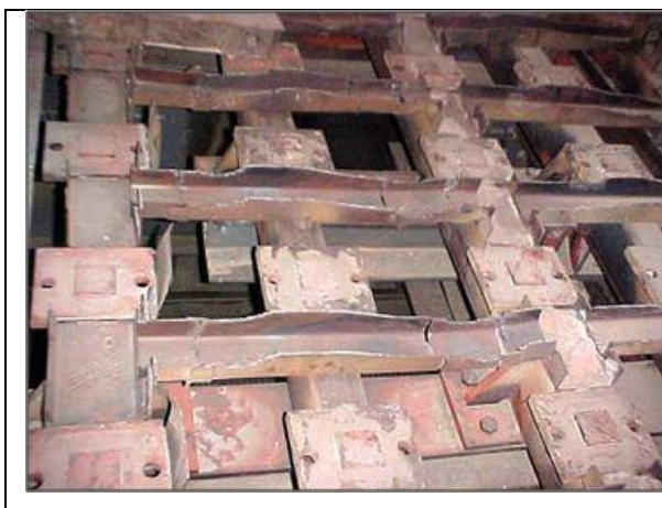
Figura 26 – Vigas centrais desgastadas Fonte: Autoria própria.
