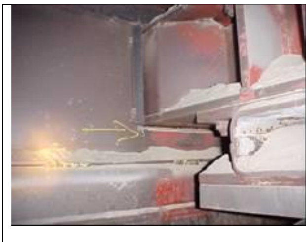
Figura 23 – Folga entre vedação e viga Fonte: Autoria própria.
