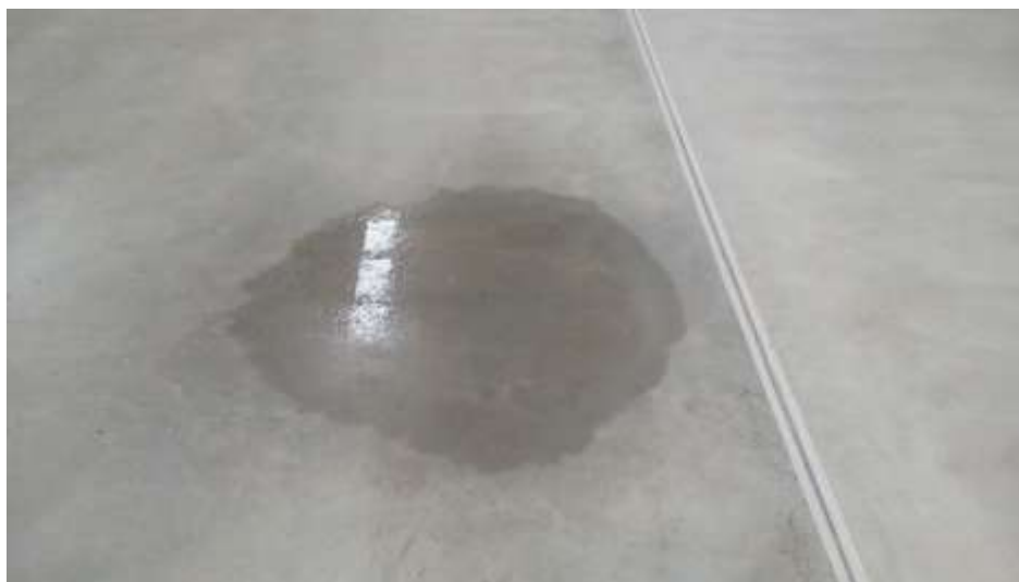
Figura 6 - Infiltrações provenientes da cobertura. Fonte: O autor, 2016.
