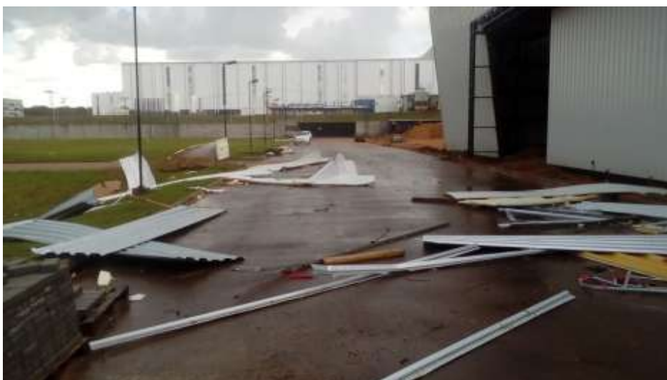
Figura 11 - Acidente com material que se encontrava na cobertura. Fonte: O autor, 2016.
