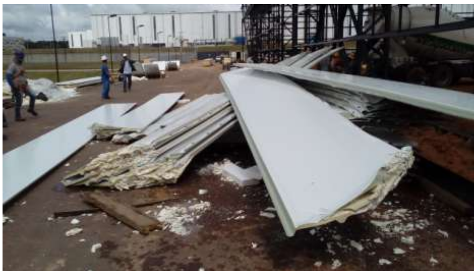
Figura 10 - Acidente durante a movimentação vertical das telhas. Fonte: O autor, 2016.
