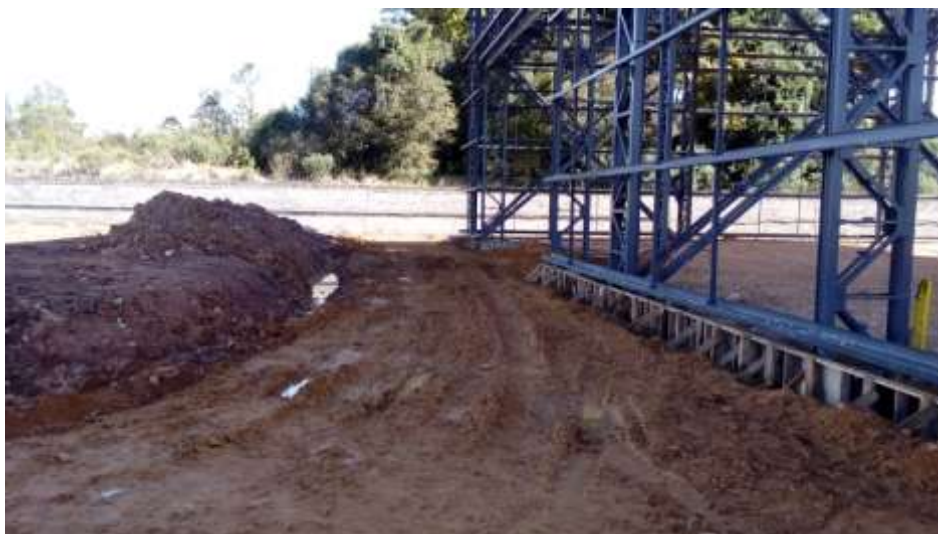
Figura 7 - Local sem acesso devido as chuvas. Fonte: O autor, 2016.
