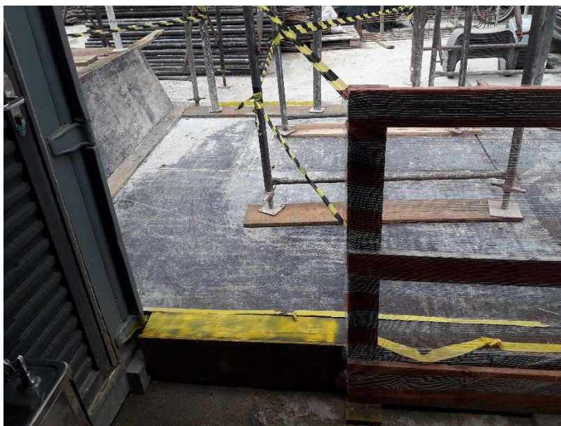
Figura 27 - Sinalização de degraus para evitar riscos de quedas. Fonte: A autora
