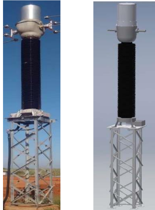
Figura 1: Transformador de Corrente 500 kV em campo e modelado pela metodologia BIM
