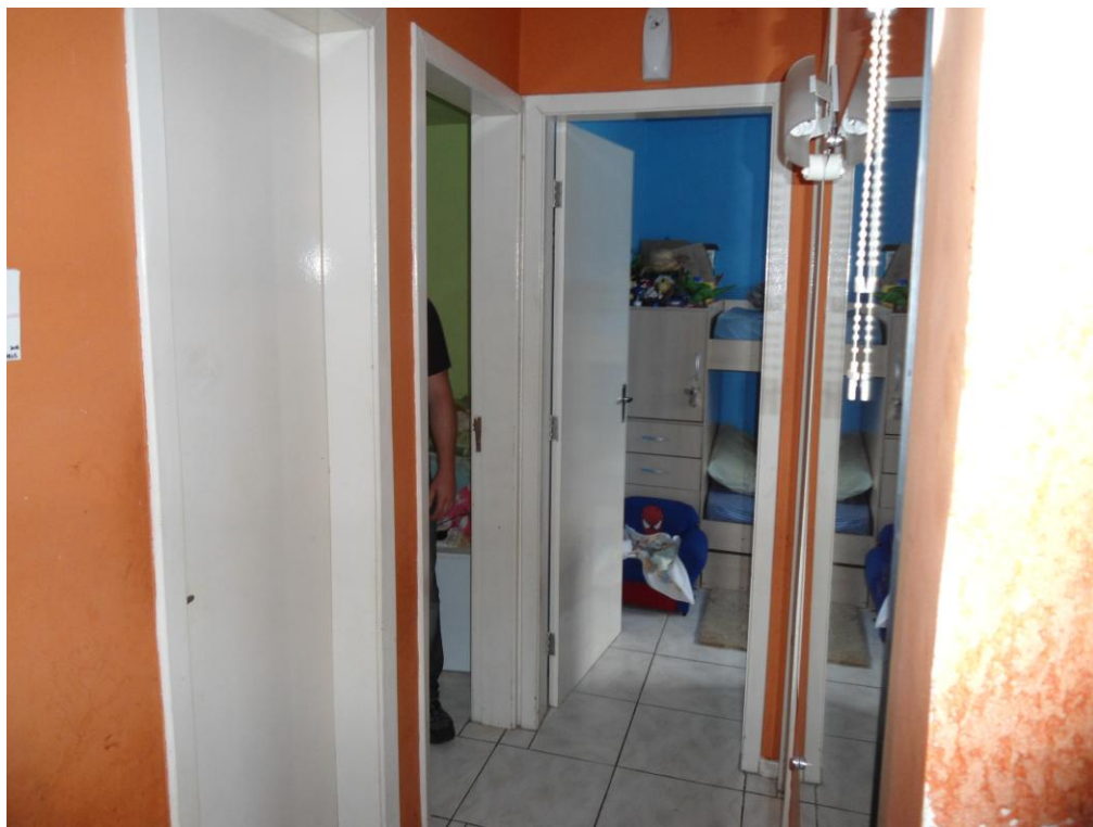
Foto 3 - Acesso aos dormitórios aonde a anomalia é visível
